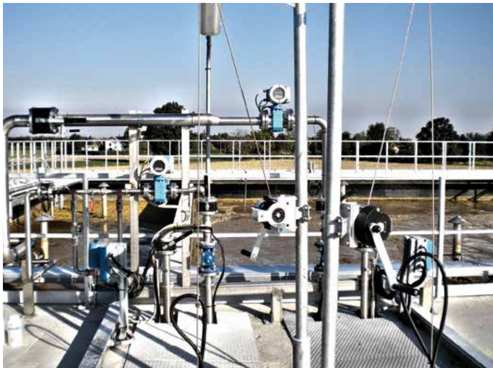
Trattamento biologico presso industria farmaceutica.
