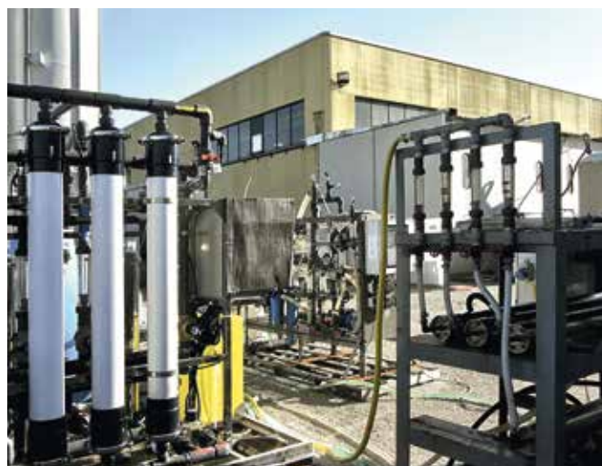
Unità di trattamento UF e RO.
