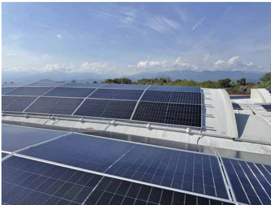
Impianto fotovoltaico realizzato per Hydromec.
